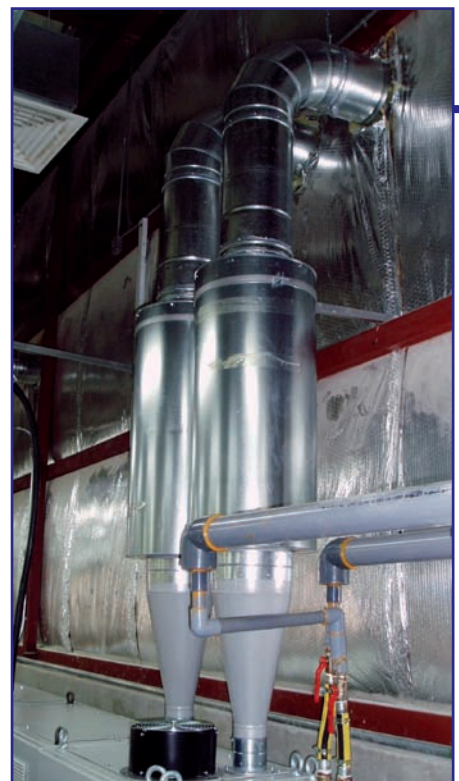
Die Abluft der UV-Luftkühlung wird durch den Gebläseschrank schalldämmend ins Freie geführt.
