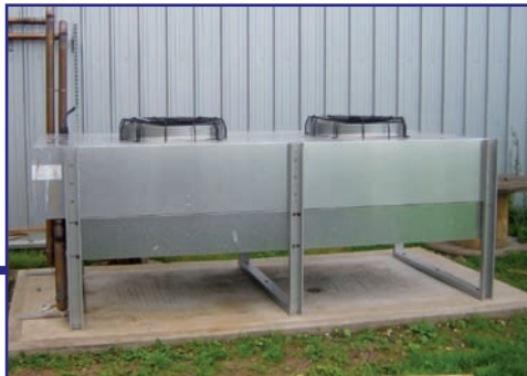
Wasser-Luft-Außenkühler von Grafix auf dem Dach einer Druckerei – die beiden gereihten Module sind ausreichend für eine gut ausgestattete UV-Anlage im Großformat.
