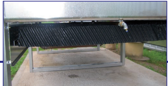
Die Kühlrippen des Außenkühlers können mit Wasser bedampft werden, dies gewährleistet auch bei Außentemperaturspitzen bis 45°C eine ausreichende Kühlleistung für die UV-Trocknung.
